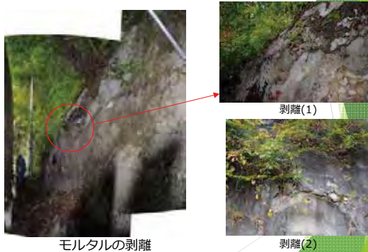
モルタルの剥離
