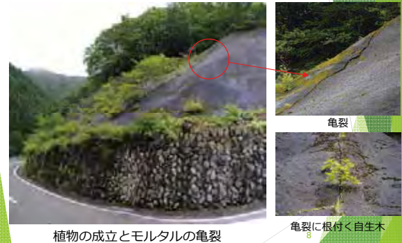
植物の成立とモルタルの亀裂
