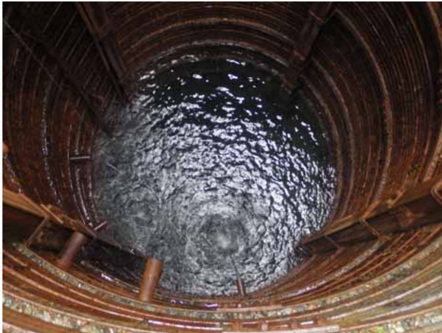
集水井の異常湛水
