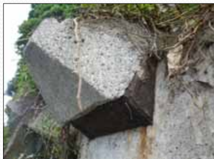
頭部コンクリートの損傷状況 (内部の角度調整箱型台座も腐食)
