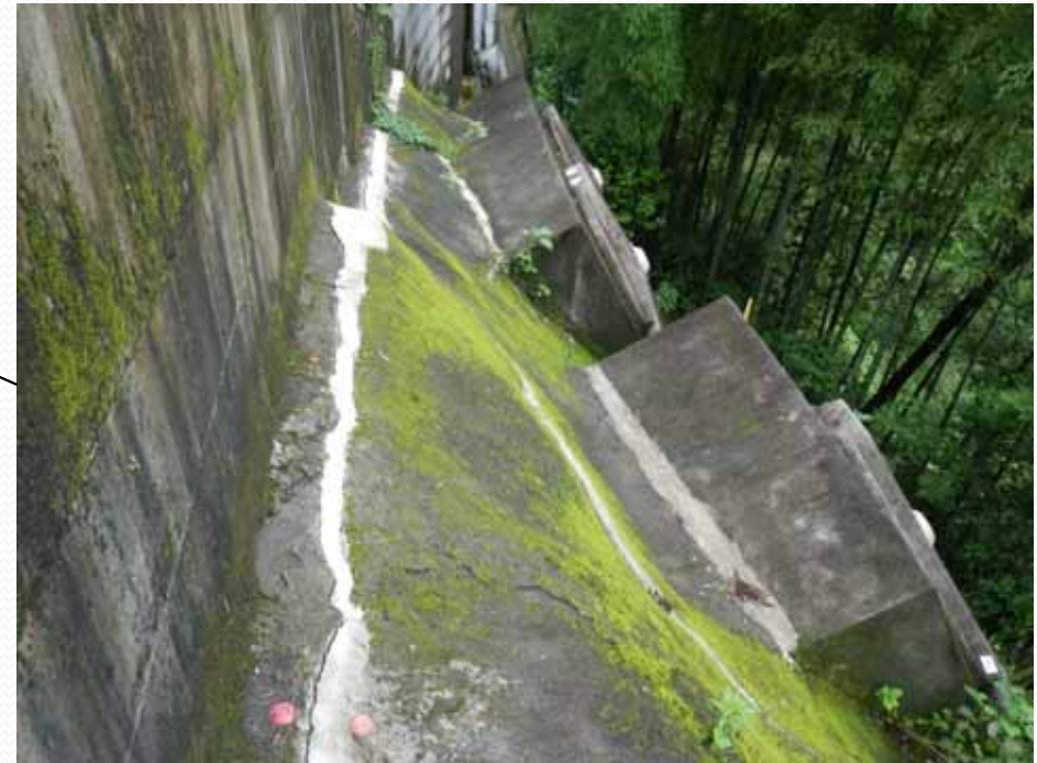
吹付工に亀裂が発生
