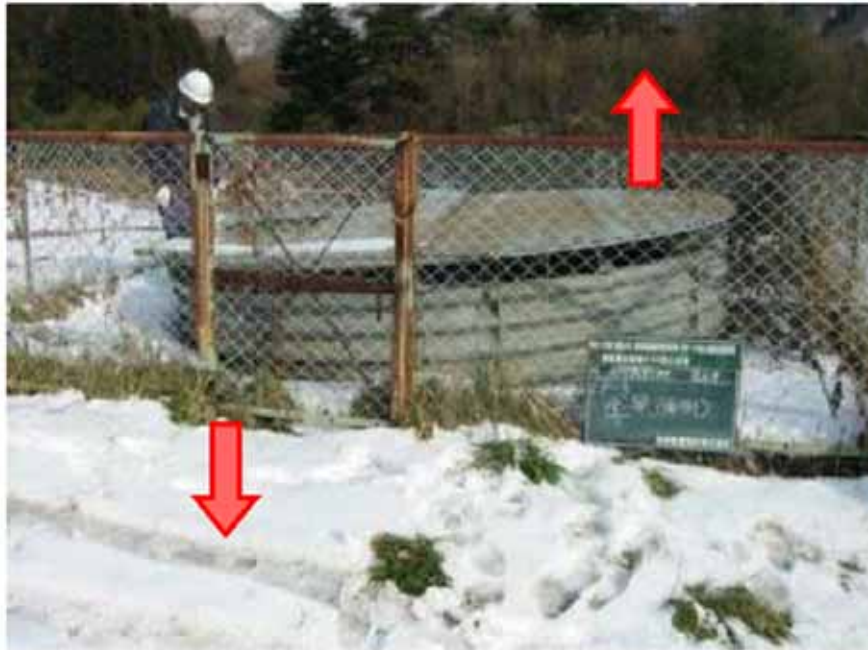
集水井の傾動 ➤ 表層すべりが原因
