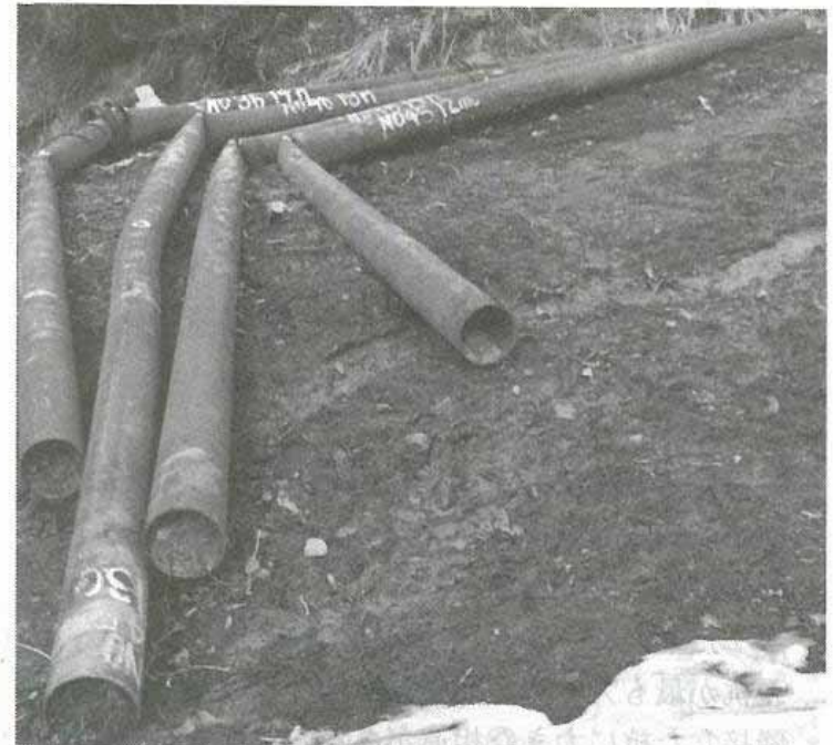
鋼管杭の変形
