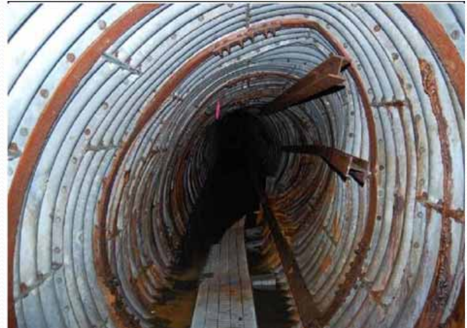
排水トンネルの変形 ➤ 地すべりが原因
